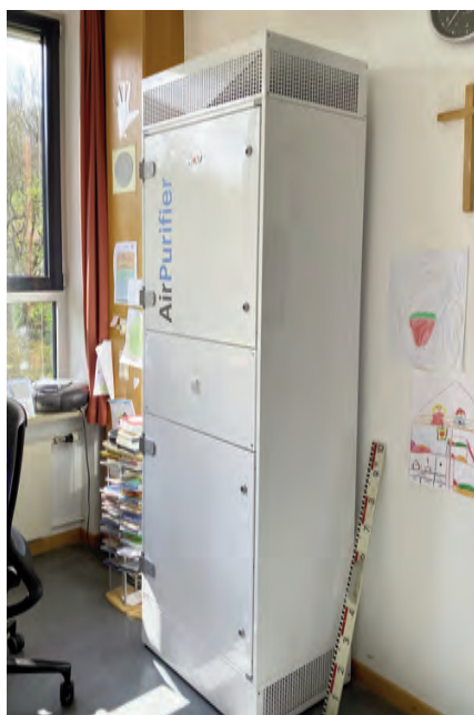
Luftreiniger an der Grundschule Altstadt
